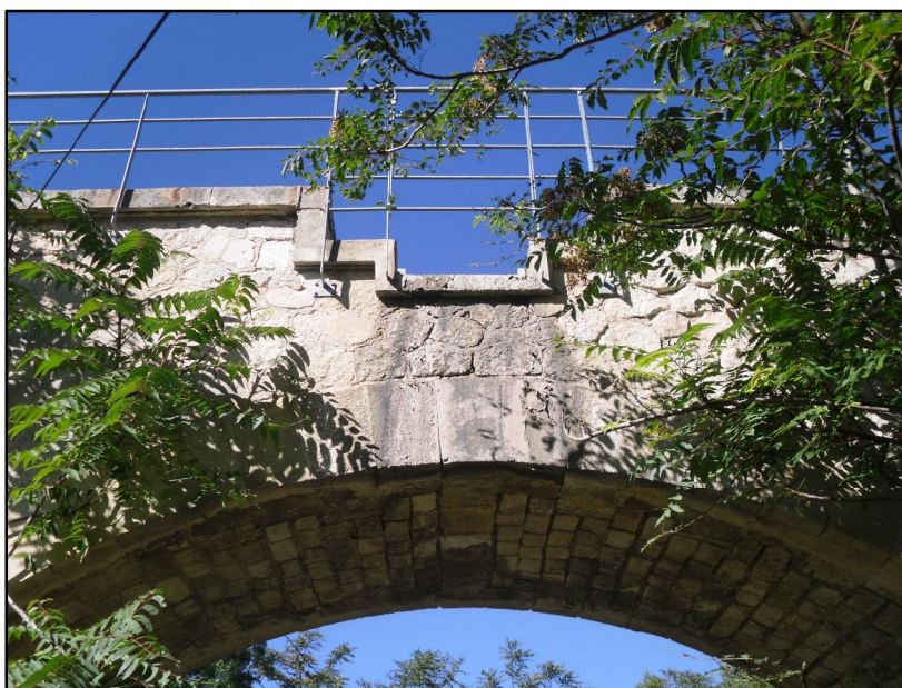
PHOTO 3 : DEVERSOIR DE SECURITE SUR L'AQUADUC DE MANVILLE (COTE AVAL)
