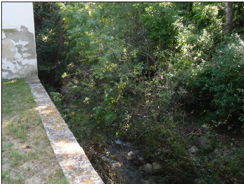
PHOTO 7 : GAUDRE DE LA CROIX EN AVAL DU CANAL D'IRRIGATION
