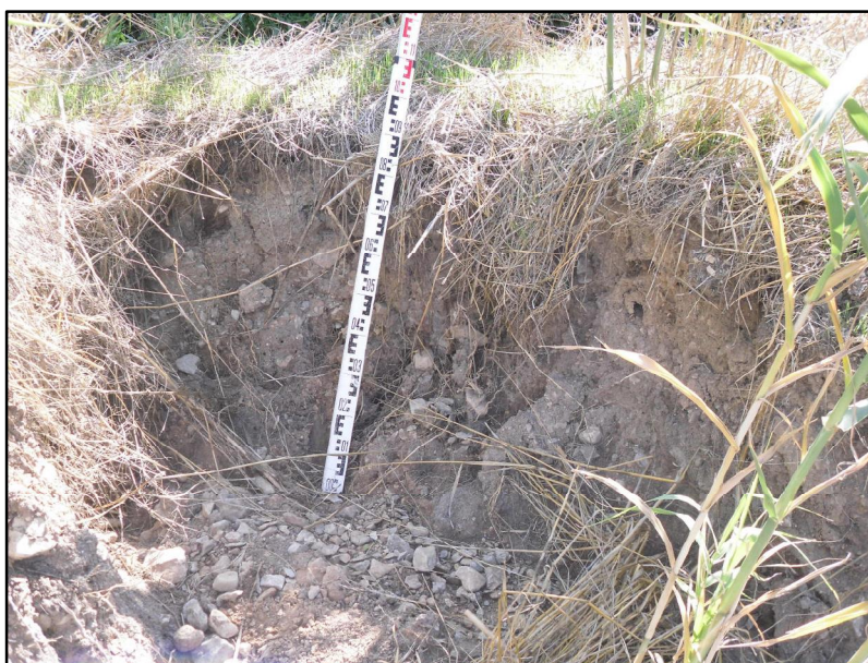
PHOTO 20 : EROSION DE BERGE EN RIVE DROITE DU GAUDRE DE LA CROIX EN AVAL DE LA RD17C
