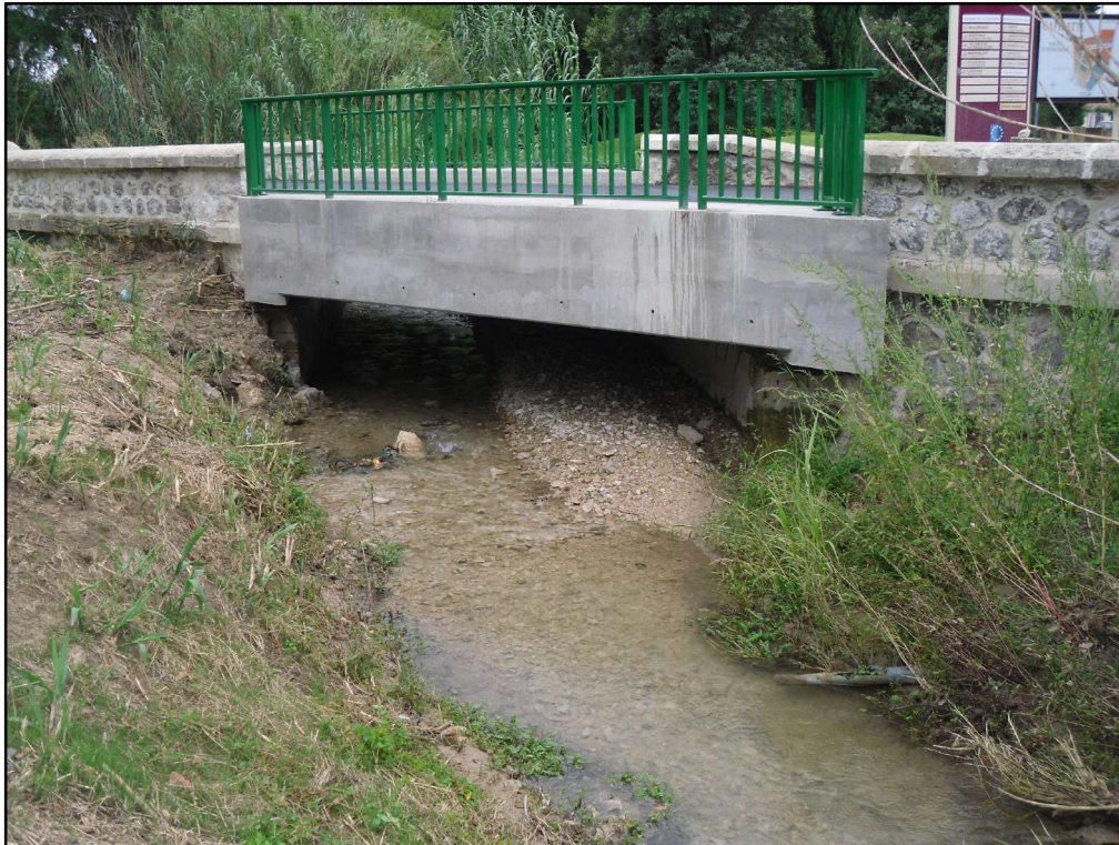
PHOTO 30 : PONT DE LA RD17C SUR LE GAUDRE DE LA FOUX
